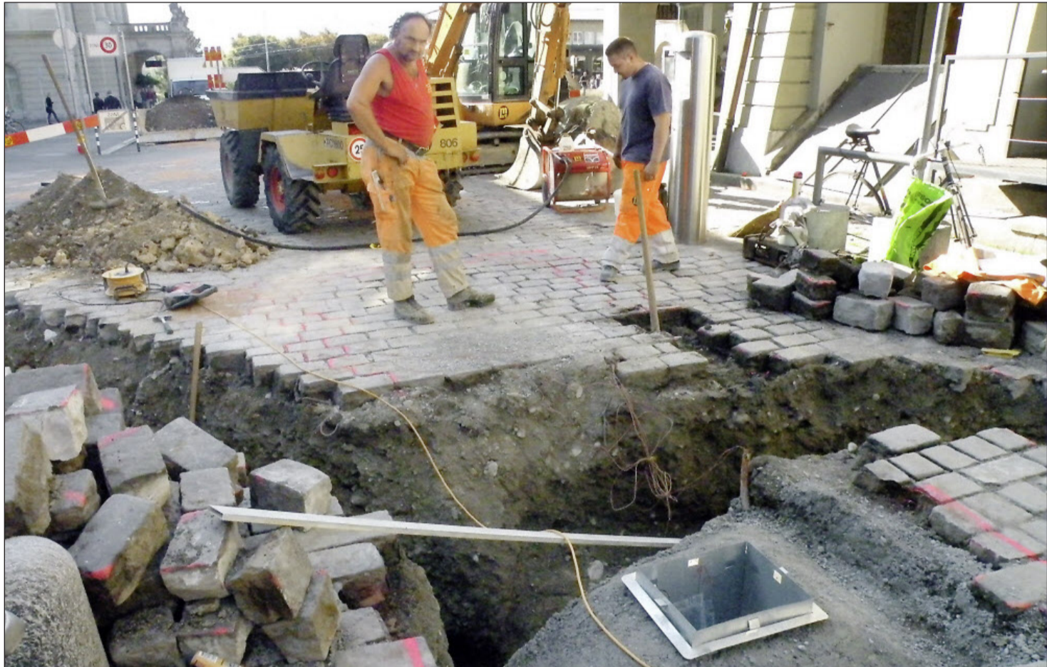
Neuer Poller in der Hotelgasse: Für den neuen, dickeren Poller sind Bauarbeiten im Untergrund nötig.
